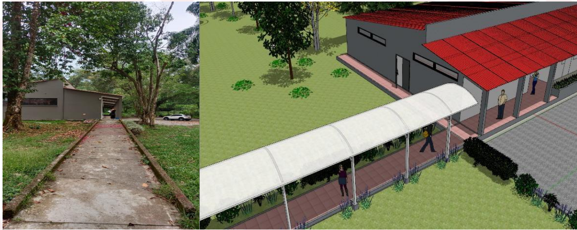
Figura 28. Instalación de piso de Gress y Domo en acrílico para comunicar el bloque 1 y 2
